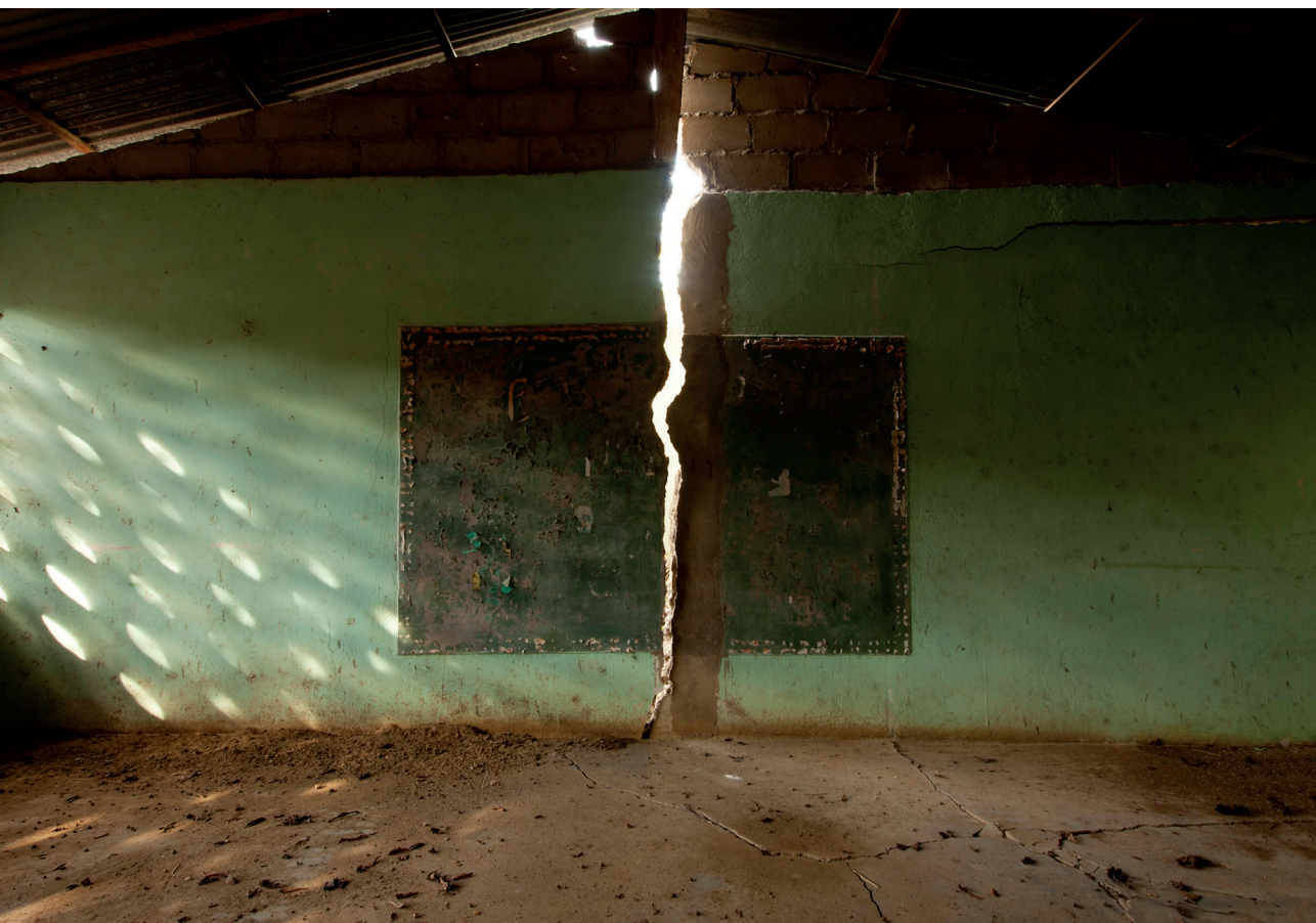
Figura 3. Silencio con grieta. Las Palmas, Bolívar, Colombia, 2011
